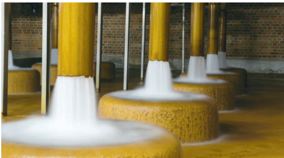
Stacja Uzdatniania Wody – napowietrzalnia
