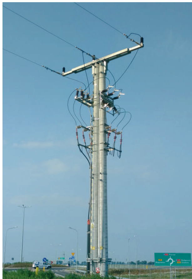
Stanowisko słupowe średniego napięcia
