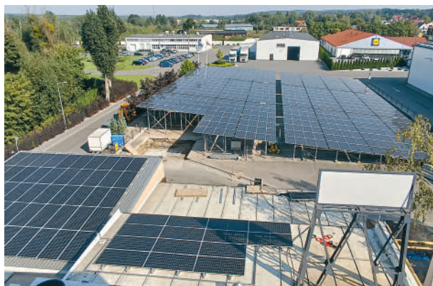
Instalacja fotowoltaiczna o łącznej mocy 330 kW
