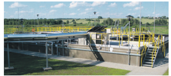
Blok biologiczny Oczyszczalni Ścieków „Południe” w Piekarach Śląskich
